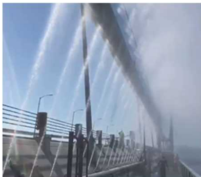
（写真）水冷却システム
